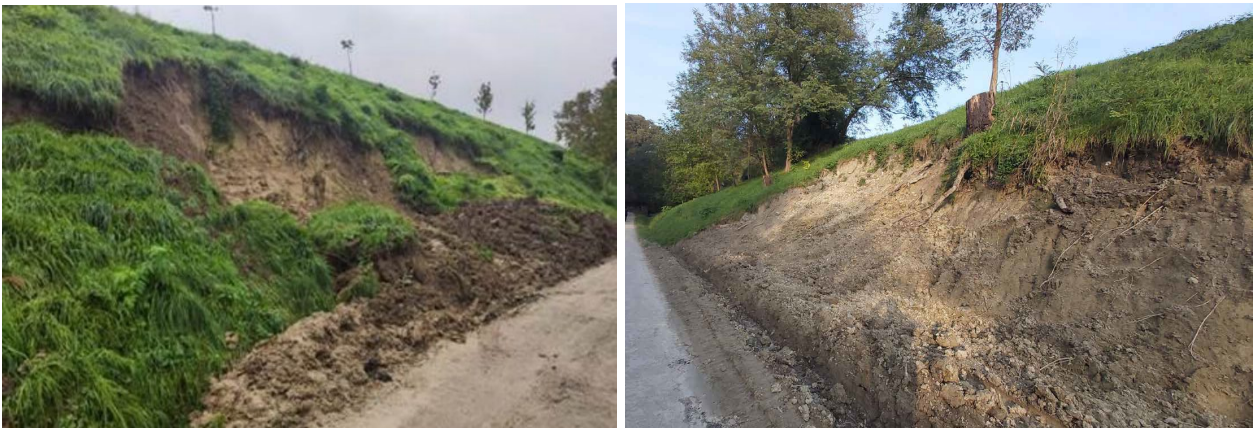
Intervento B.a.1.12: situazione post alluvione (foto1) e post interventi di messa in sicurezza (foto2)
