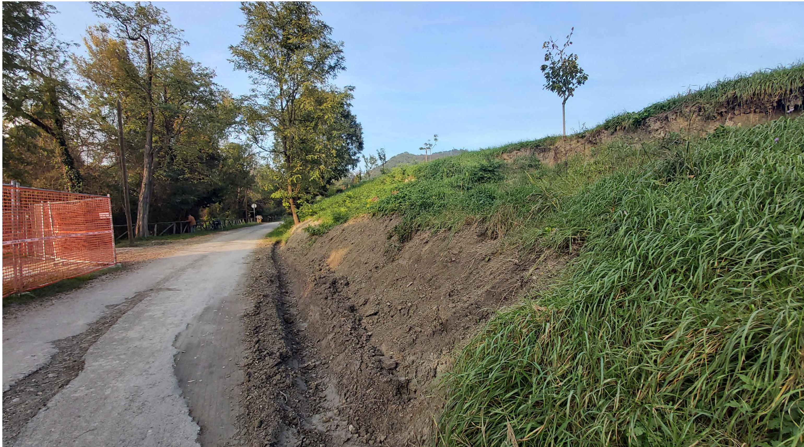
RIPRESA DELLA FRANA 3 - Nuovo Scivolamento verificatosi all'altezza di Villa Ada
