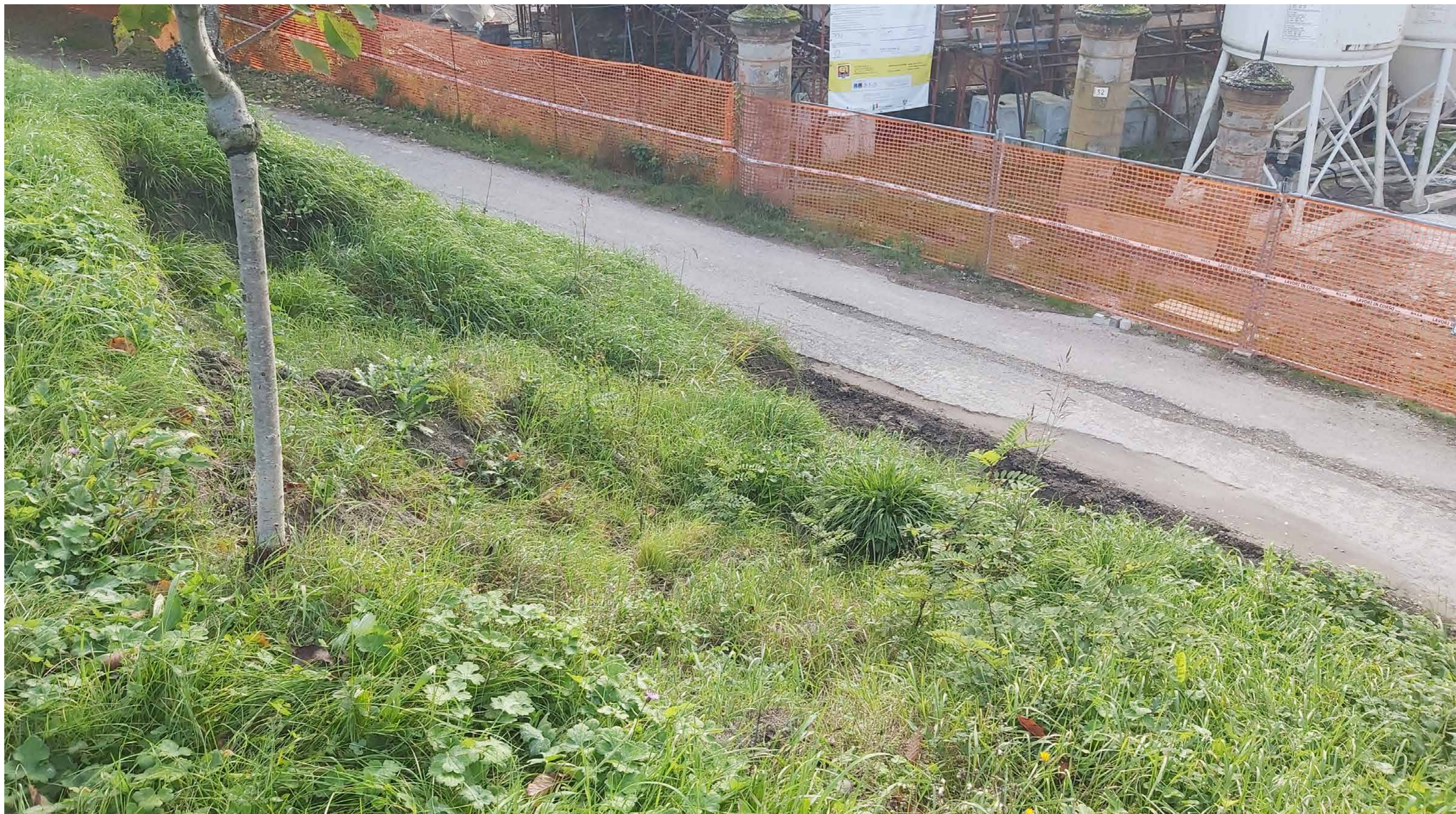
RIPRESA DALL'ALTO DELLA FRANA 3
